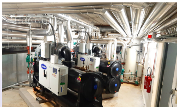
↑ Pompes à chaleur géothermiques sur eau de nappe assurant le chauffage et la climatisation du bâtiment Sud sur le campus Hannah Arendt.
